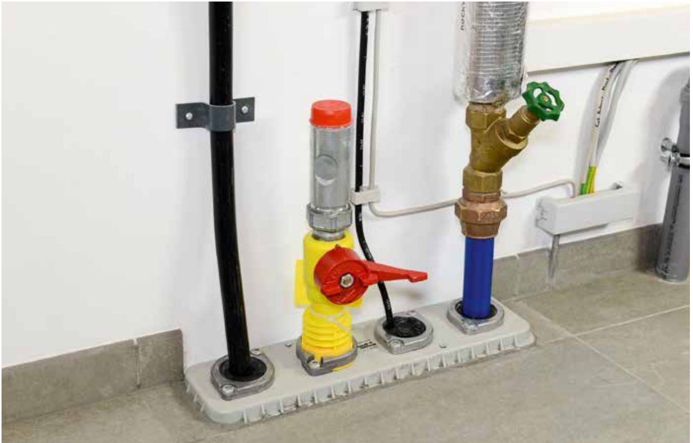
Beispielhafte Anordnung von Netzanschlüssen mit MSH im Gebäude ohne Keller (Quelle: Hauff-Technik GmbH & Co. KG)
